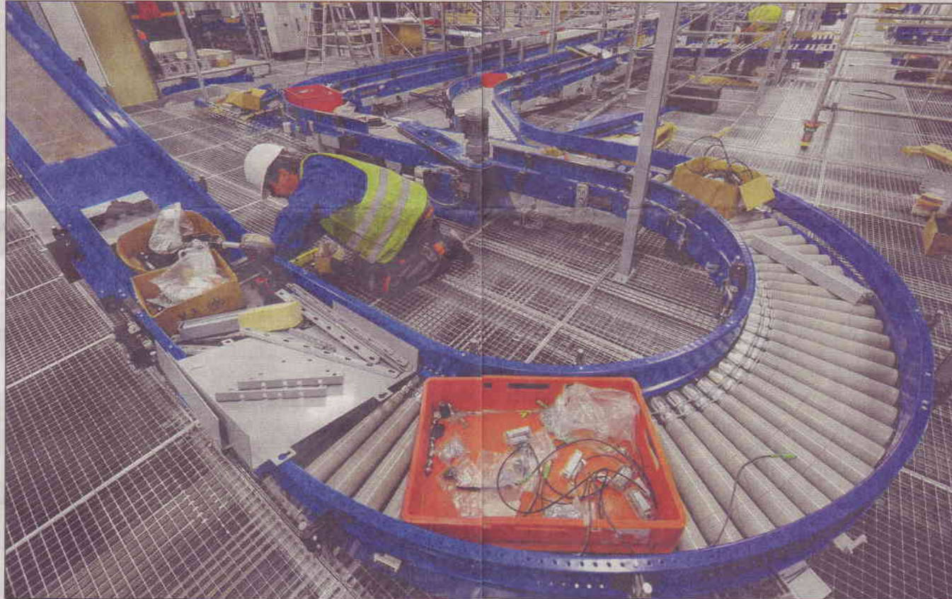
DIE FÖRDERBÄNDER IM NEUEN EDEKA-FLEISCHWERK in Rheinstetten sind bereits im Probetrieb.
